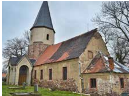
Die Beispielkirche in Kösseln in Mitteldeutschland war fast aufgegeben wegen der schweren Schäden, sie ist aber auf einem guten Sanierungsweg. Eine starke Gemeinde kämpft und hilft bei der Sanierung!
