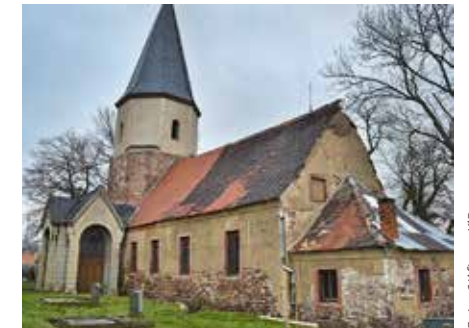
Die Beispielkirche in Kösseln in Mitteldeutschland war fast aufgegeben wegen der schweren Schäden, sie ist aber auf einem guten Sanierungsweg. Eine starke Gemeinde kämpft und hilft bei der Sanierung!
